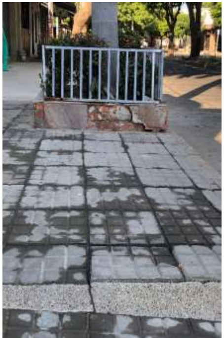
Fig No 4. Deterioro de estructura.
