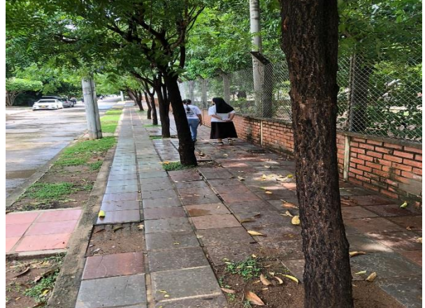
Árboles Para intervenir con poda de la especie Neem ( Azadirachta indica ), Ubicado en la Transversal 8No 2c -174 barrio los campanos de Valledupar- Cesar.
