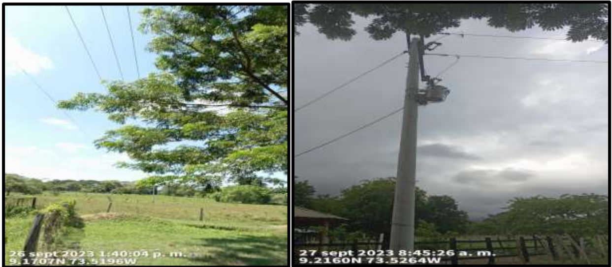
Imagen 101 y 102. de los árboles muestran la amenaza de entrelazarse las ramas con las redes eléctricas de media tensión, Recorrido kmz - tracks, zona rural de Chiriguaná.
