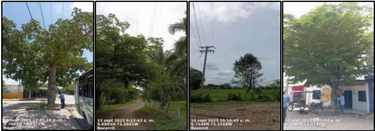
Imagen 23, 24, 25, 26,- de los árboles muestran la amenaza de entrelazarse las ramas con las redes eléctricas de baja y media tensión.
