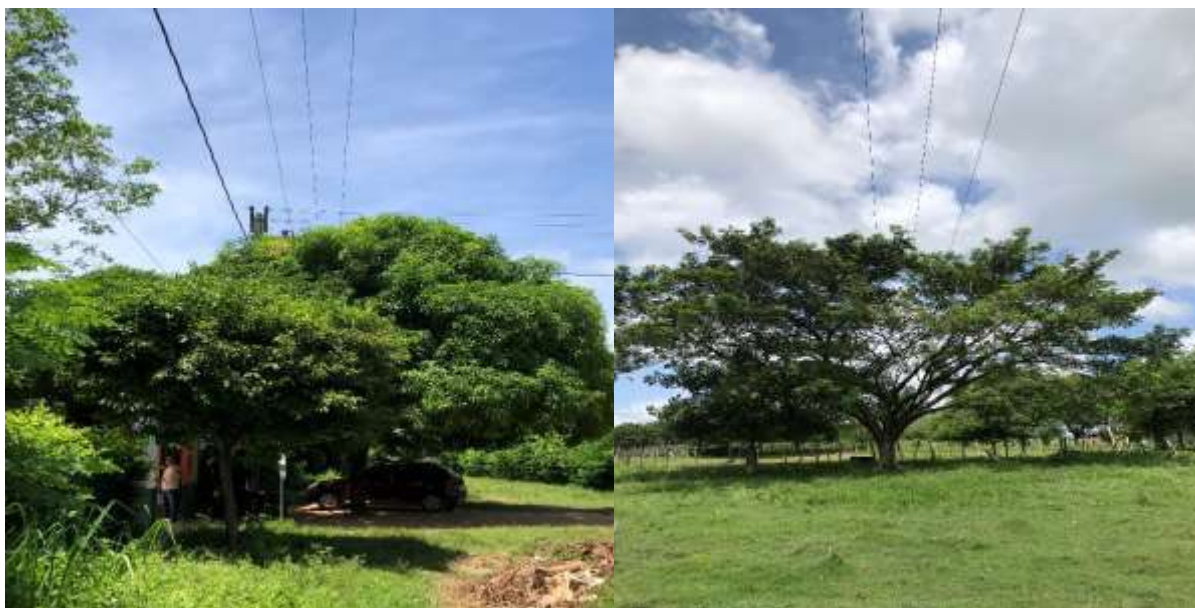
Imagen 87 y 88. de los árboles muestran la amenaza de entrelazarse las ramas con las redes eléctricas de baja y media tensión, Recorrido kmz - tracks, zona urbana y rural de Astrea.
