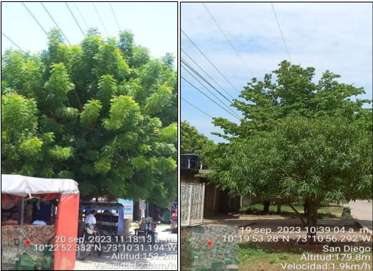
Imágenes 12 y 13. de los árboles muestran la amenaza de entrelazarse las ramas con las redes eléctricas de baja y media tensión Recorrido kmz - tracks, zona urbana San Diego.
