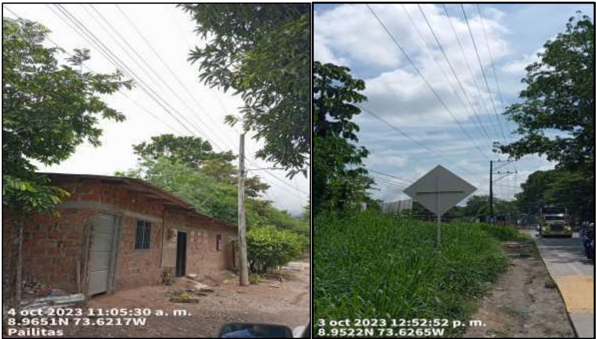
Imagen 107 y 108. de los árboles muestran la amenaza de entrelazarse las ramas con las redes eléctricas de baja y media tensión, Recorrido kmz - tracks, zona urbana de Pailitas.
