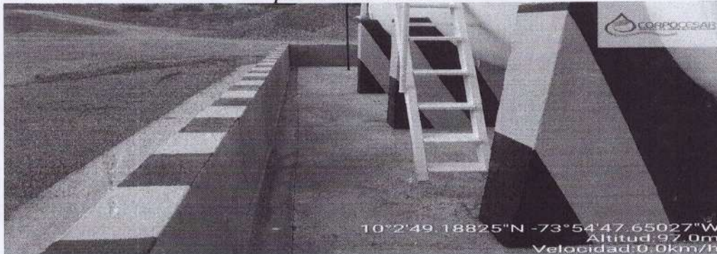
Imagen 4. Vista general, sistema de dique perimetral y drenaje, cimentación, base del tanque y piso duro en concreto.
