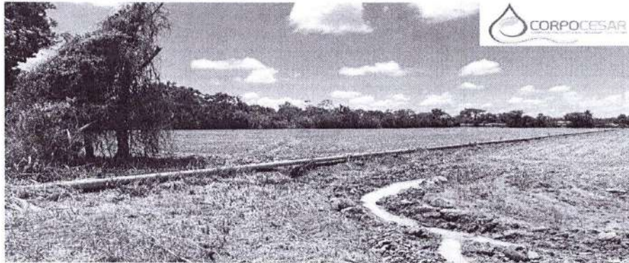
Ilustración 4. Estado ACTUAL del sitio de ocupación, Quebrada El Barro PK 85+265 del Oleoducto Ayacucho – Galán
