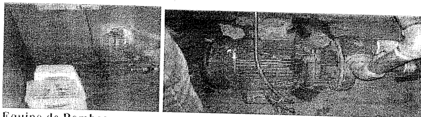
Equipo de Bombeo
